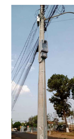
Caixa de medição padrão CPFL
