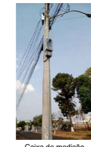
Caixa de medição padrão CPFL
