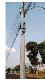
Caixa de medição padrão CPFL
